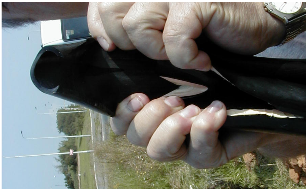
Obrázek 3: Poškození těla spojky
