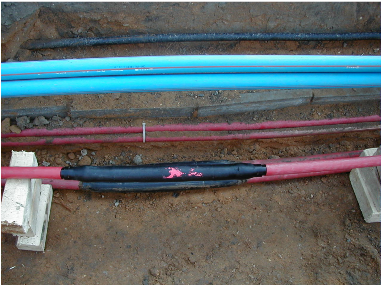
Obrázek 1: Pohled na vadnou spojku ve výkopu
