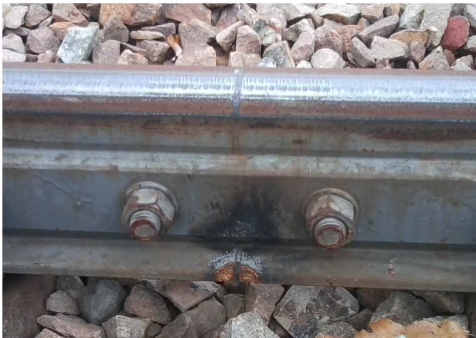
Obr. 21 Poškození izolovaného styku elektrickým obloukem v žst. Kařízek
