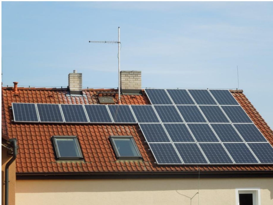
Obr.3.2.4-2 – Fotovoltaické panely na střeše rodinného domu (vlastní foto)
