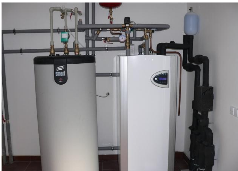
Obr.3.2.2-3 – Tepelné čerpadlo – kompresorová jednotka (vpravo) a zásobník na TUV (vlevo) (převzato z [54])
