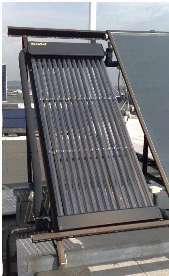
Obrázek 1.10: Trubicový solární kolektor
