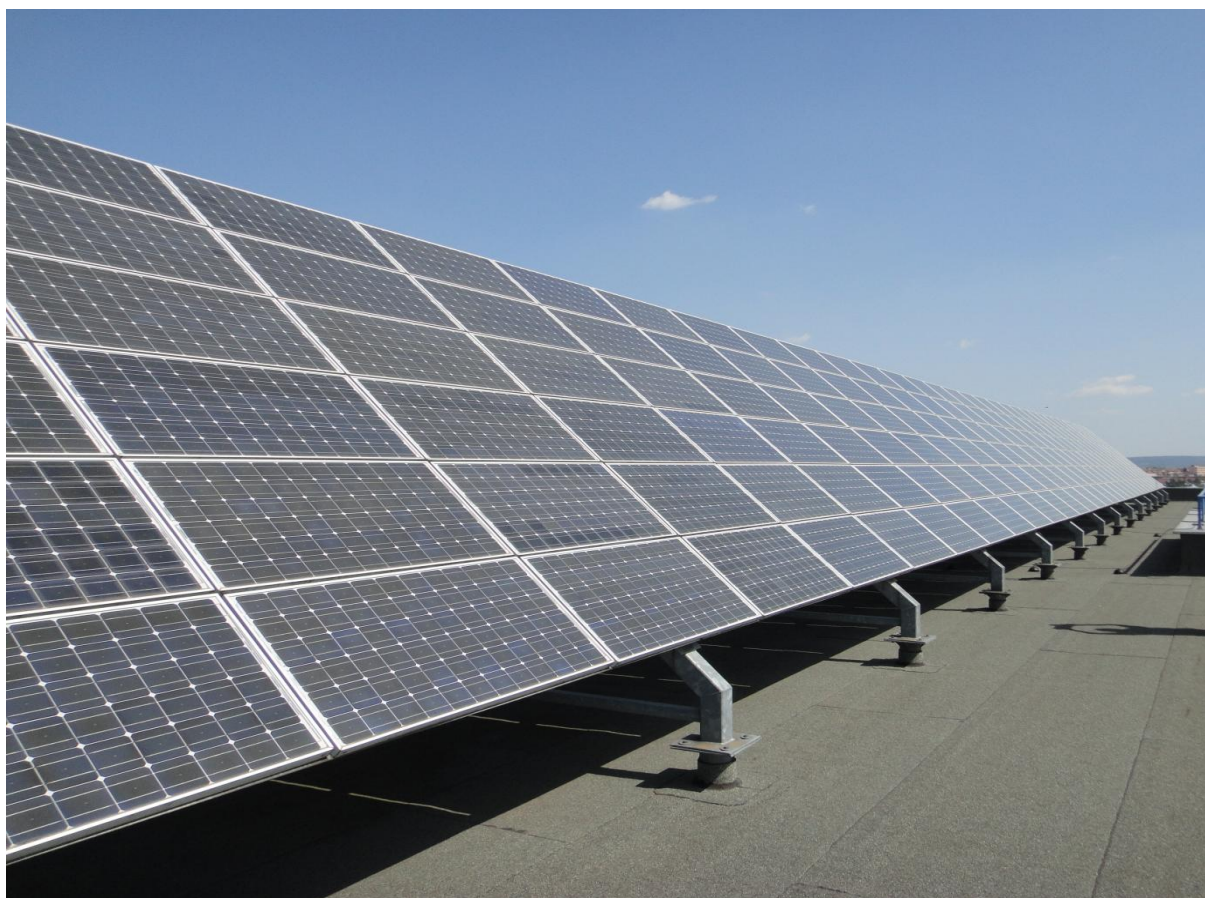
Obr. 14 – Snímek fotovoltaické elektrárny umístěné na střeše budovy ZčU FEL
