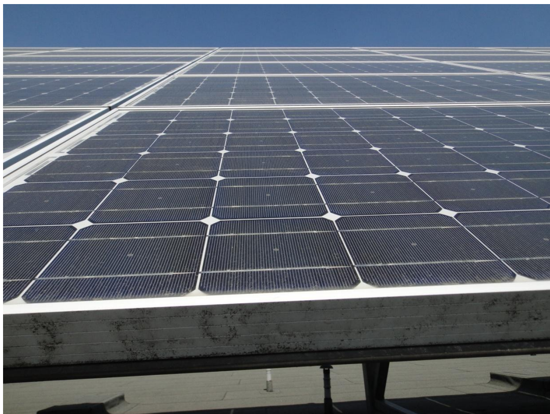
Obrázek 3 - Snímek FV elektrárny umístěné na střeše budovy ZčU FEL
