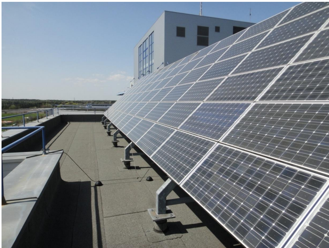
Obrázek 1 - Snímek FV elektrárny umístěné na střeše budovy ZčU FEL
