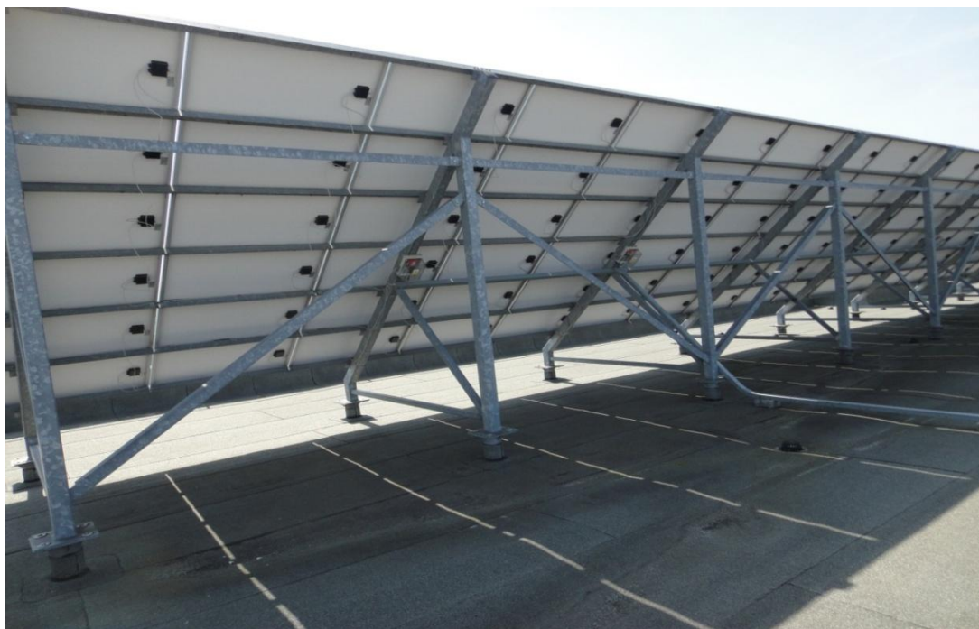
Obrázek 2 – Snímek zadní strany FV elektrárny umístěné na střeše budovy ZčU FEL
