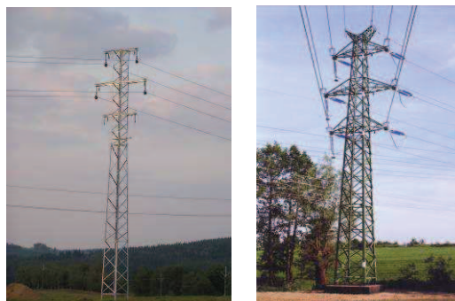
Obr. 1-1 Příhradové stožáry 22 kV
