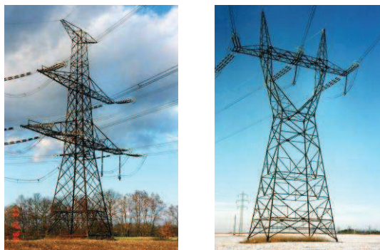
Obr. 1-2 Příhradové stožáry 400 kV
