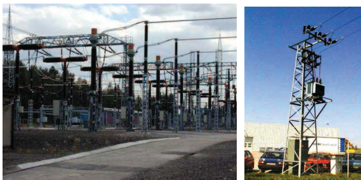
Obr. 1-3 Rozvodna a příhradová trafostanice
