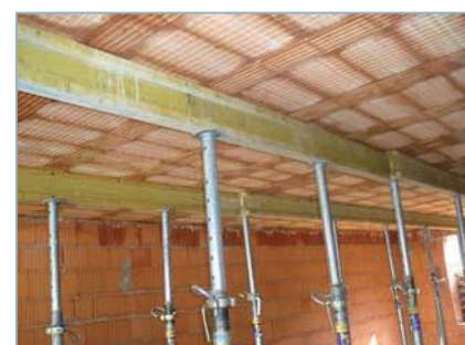
Podpory stropu musí být zavětrovány, podloženy a podklínovány, osová vzdálenost sloupků ve směru podpor (hranolů) nesmí překročit 1,5 m.
