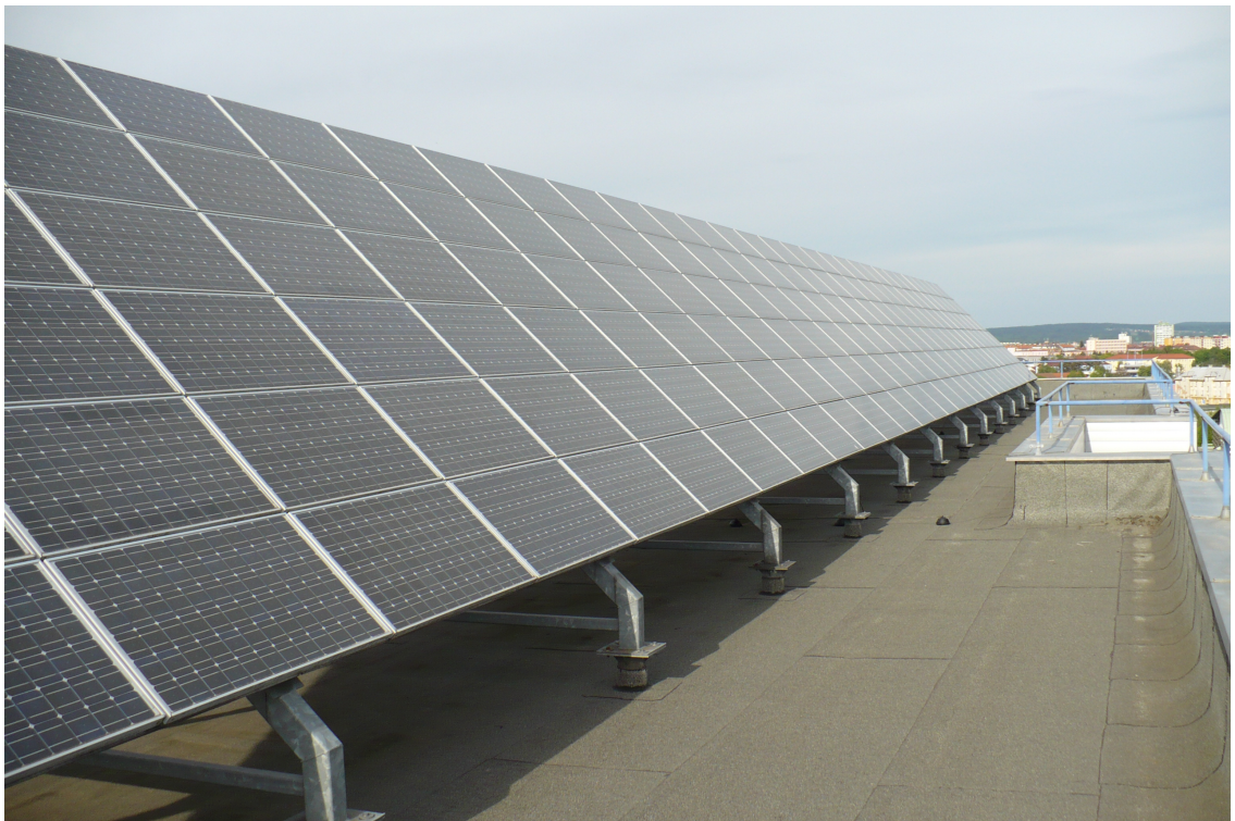
Obr. 10 Fotovoltaická elektrárna (6x30 panelů)
