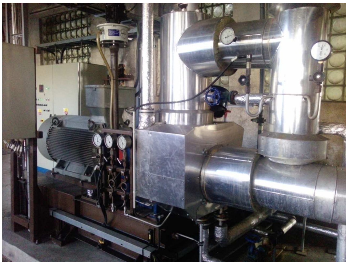
Obr. 4.11 Elektrický generátor a parní stroj Františkolázeňské výtopny
