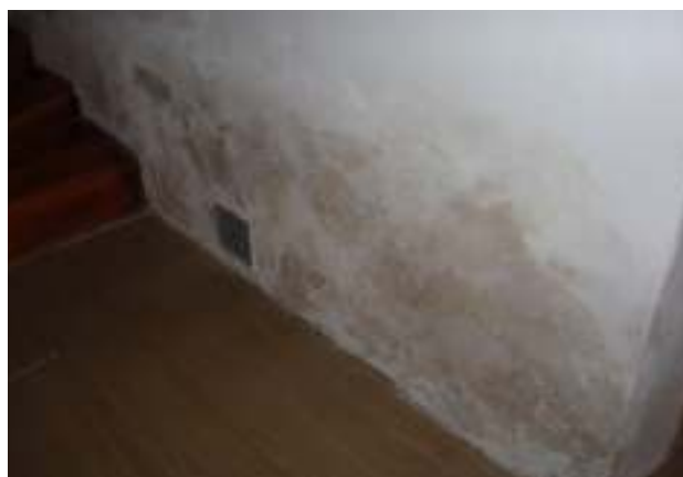
Obr. č.3-Vlhkost v chodbě
