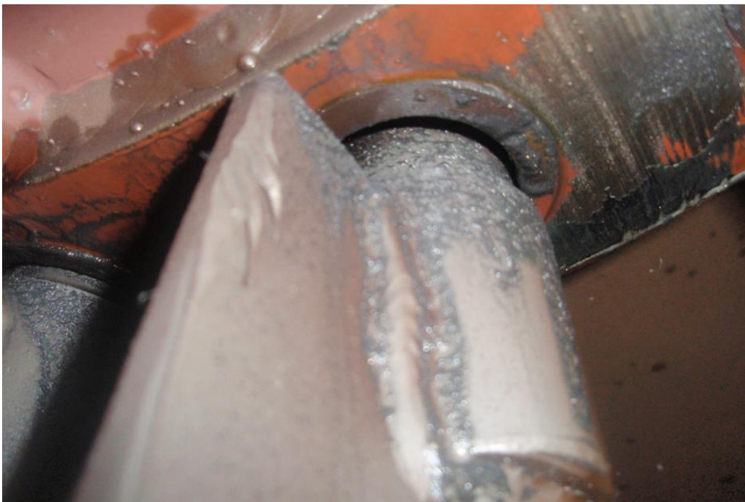
Obr. 4-5 - Vůle v uložení regulačních lopatek kouřového ventilátoru [19]
