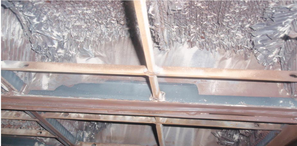
Obr. 4-4 - Poškozené teplosměnné plochy košů regeneračního ohříváku [18]
