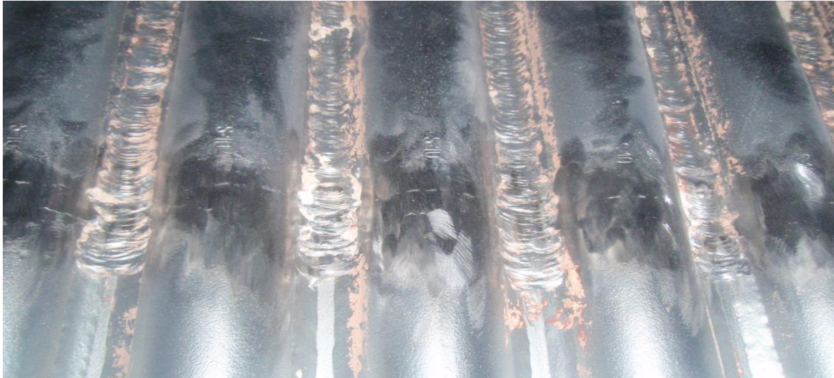
Obr. 4-6 - Poškození tlakového celku chladiče fluidní vrstvy abrazi [20]
