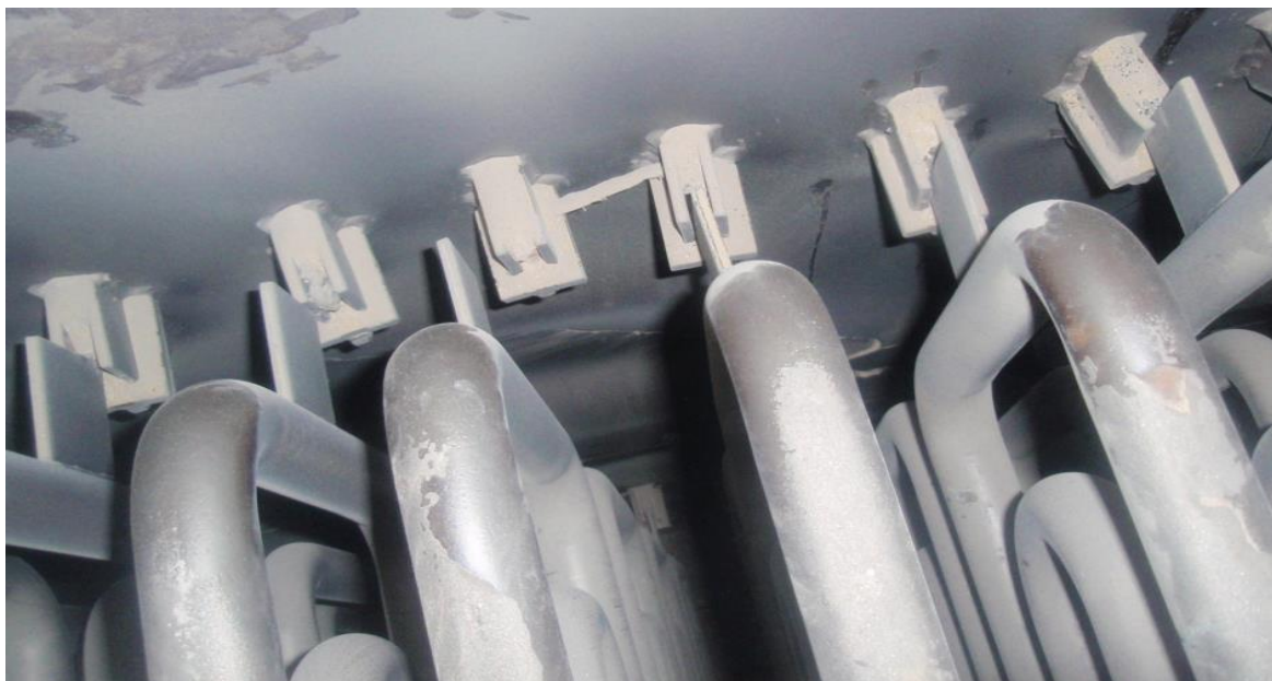
Obr. 4-7 - Poškozené závěsy chladících hadů a skříně chladiče popela [21]
