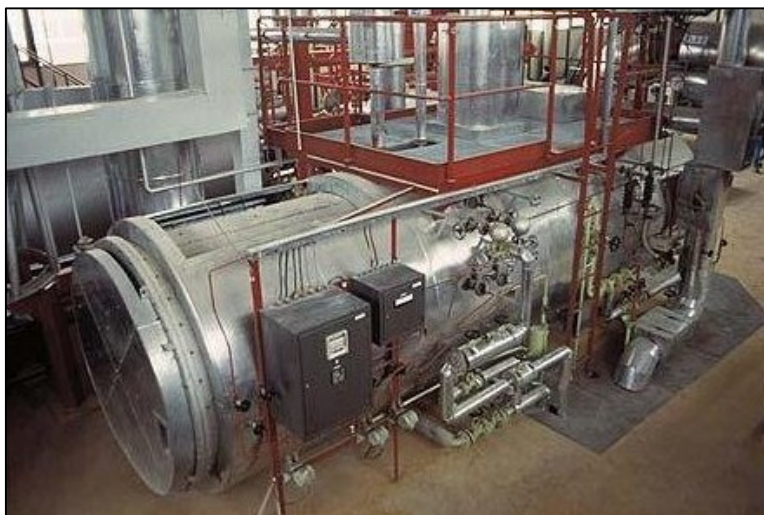
Obr. 7 Kotel spalovny odpadů[7]
