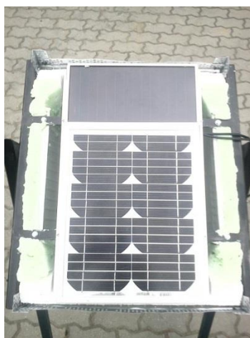
Obr. 4.2 Umístění FV panelů v chladicím prostoru
