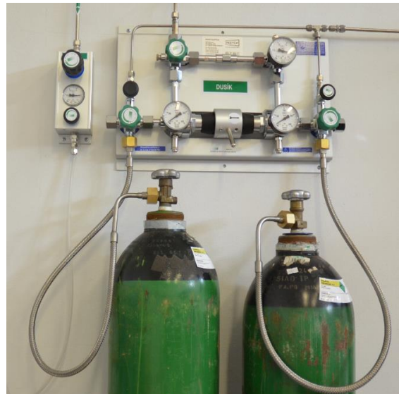
Obr.25 Rozvod dusíku – ventily
