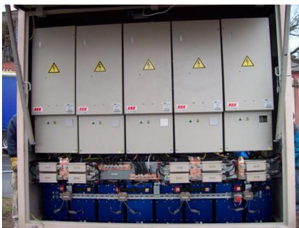
Obrázek 5.2 : Energetická posilovací stanice EPOS
