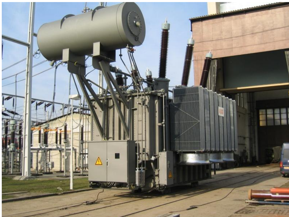
Obr. 8: Olejový transformátor s radiátory a ventilátory (10)
