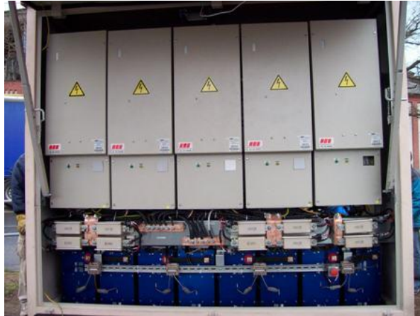
Obrázek 5.2 : Energetická posilovací stanice EPOS převzata z [6]
