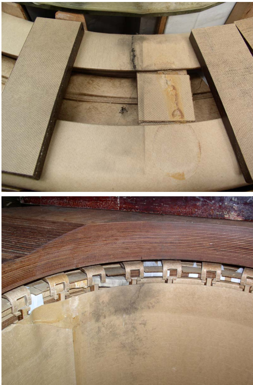
Obr. 34. Příklad porušení izolace výkonového transformátoru
