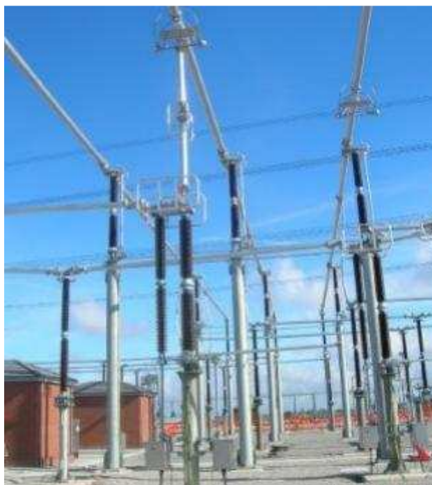
Obr. 18 SPV Pantografový odpojovač [Zdroj společnost ALSTOM]
