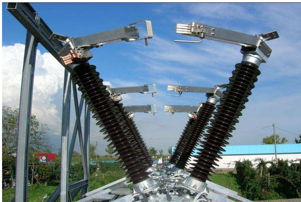
Obr. 15 Odpojovač VCB V- Typ [Zdroj společnost ALSTOM]
