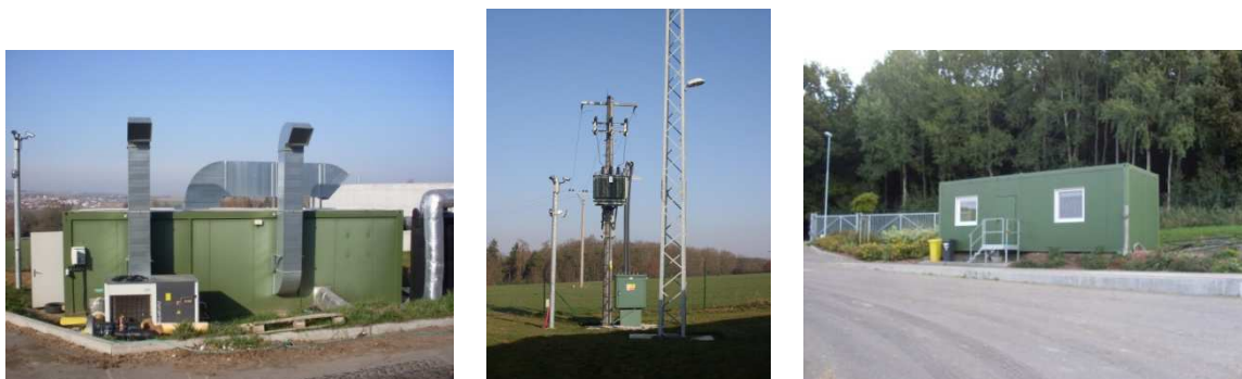
Obr. č. 24 : Tlaková stanice, transformátor, technické zázemí [vlastní foto]
