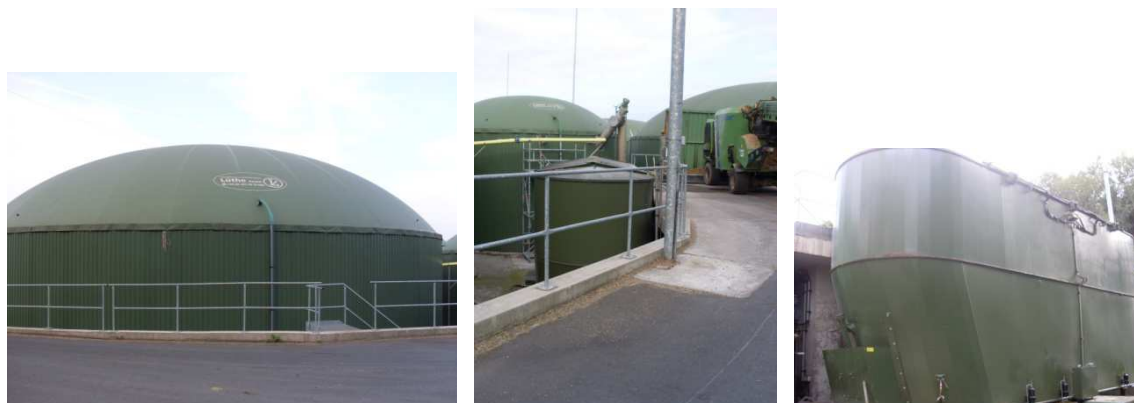
Obr. č. 15 : Fermentory, vstupní dávkovací zařízení [ vlastní foto]
