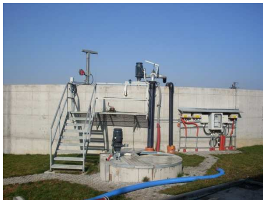
Obr. č. 20 : Skladovací nádrž fugátu [vlastní foto]
