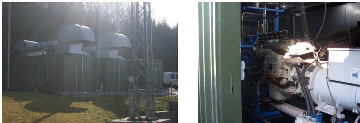
Obr. č. 9 : Kogenerační jednotky BPS Úslava Bioenergie [vlastní foto]
