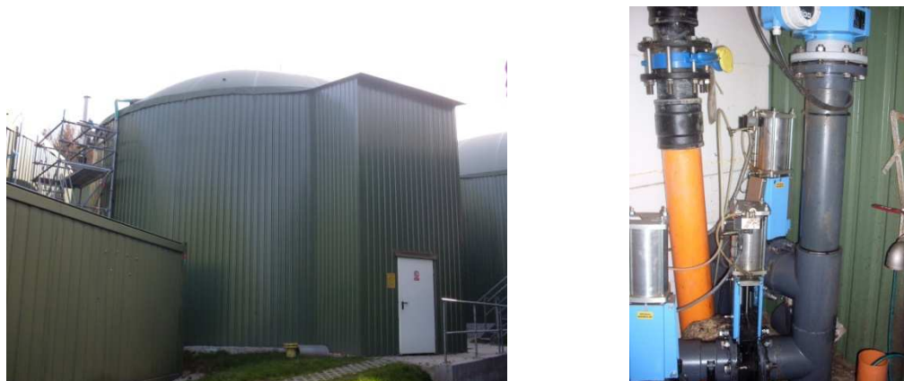
Obr. č. 16 : Objekt hydrolýzy, vnitřní zařízení [ vlastní foto]
