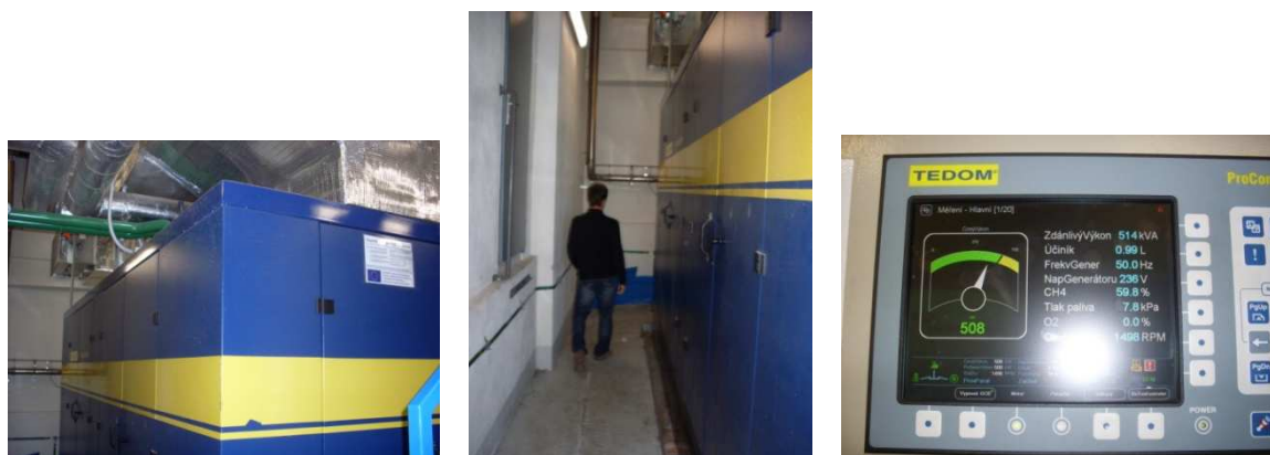
Obr. č. 30 : Umístění KGJ v Palackého ulici v Přešticích [vlastní foto]
