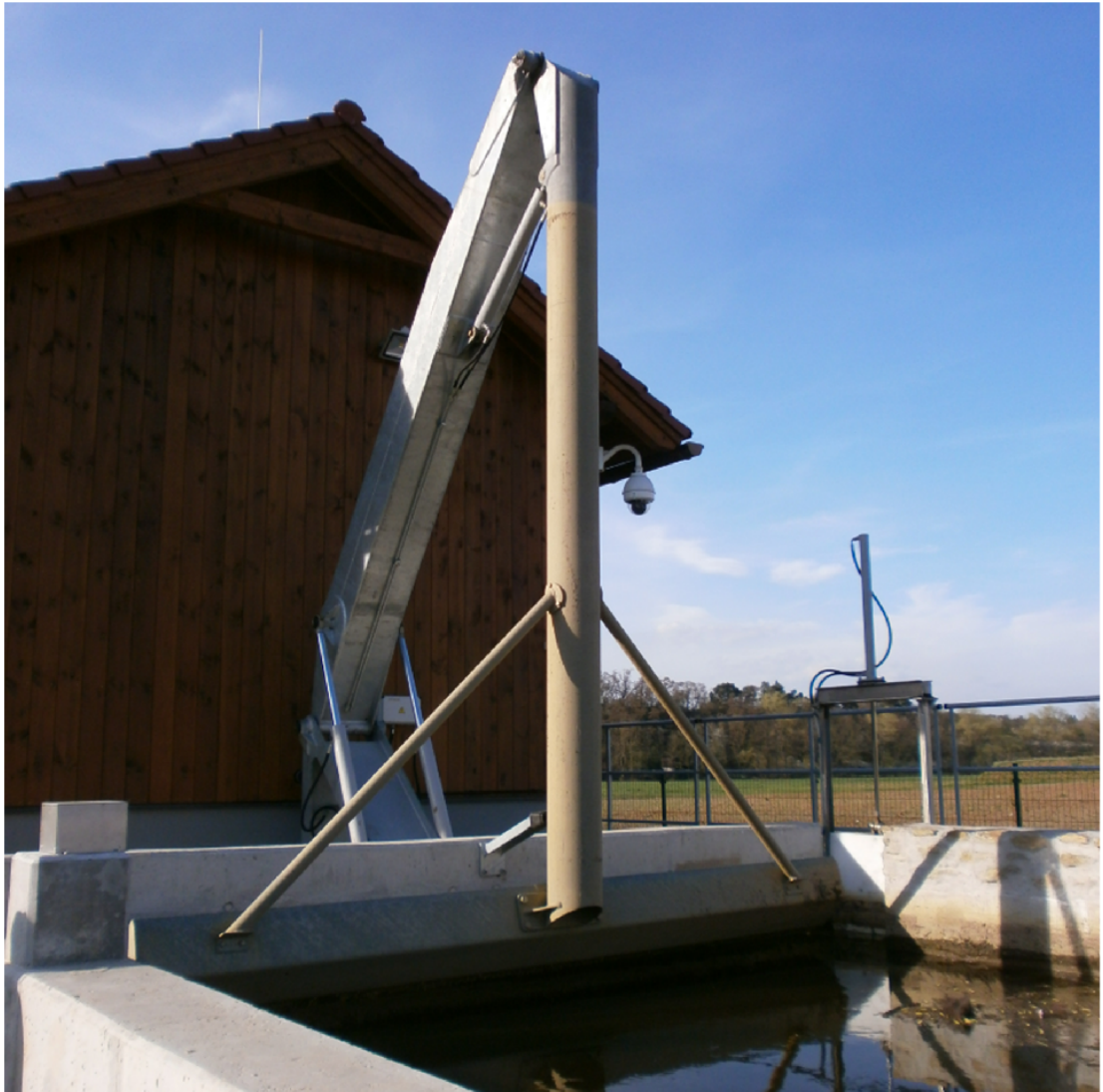
Obrázek 1.4-1 Čistící stroj česlí MVE Hradiště, vlastní foto
