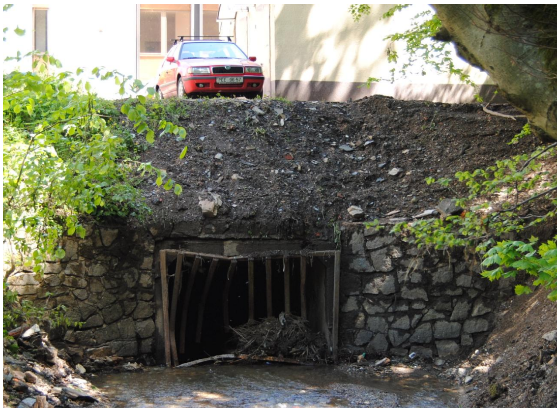
Obr. 17: Janský potok, poškozený vtok do tunelu, jímž potok protéká pod Janskými Lázněmi (zdroj: Šimon Kokoška, 11. 6. 2013).
