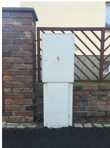
Obr.1.6.1-1 Hlavní domovní kabelová skříň rodinného sídla
