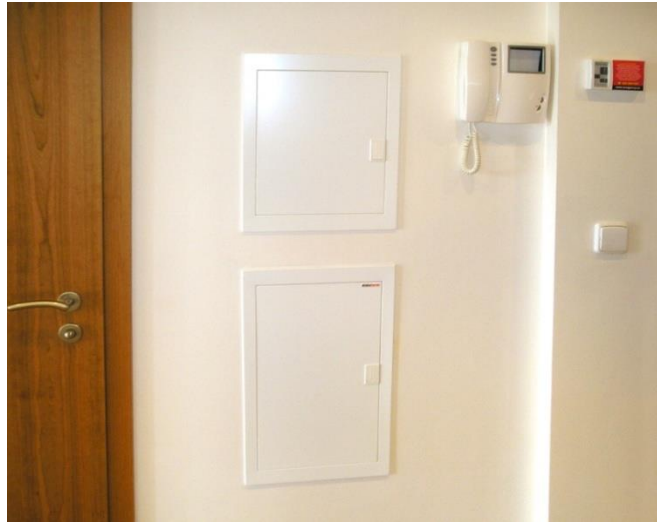
Obr.1.6.5-1 Bytový rozvaděč a datový bytový rozvaděč v objektu rodinného sídla
