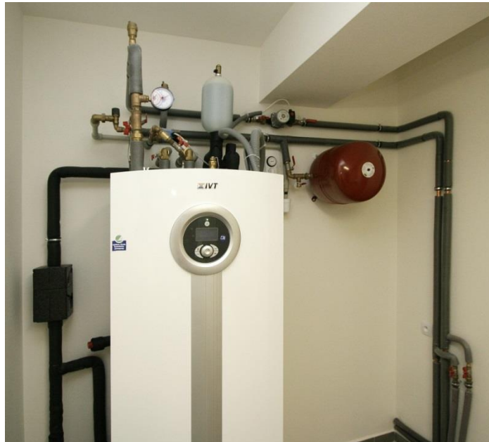
Obr.5.1-1 Tepelné čerpadlo IVT Greenline C7 v objektu rodinného sídla (převzato z [35])
