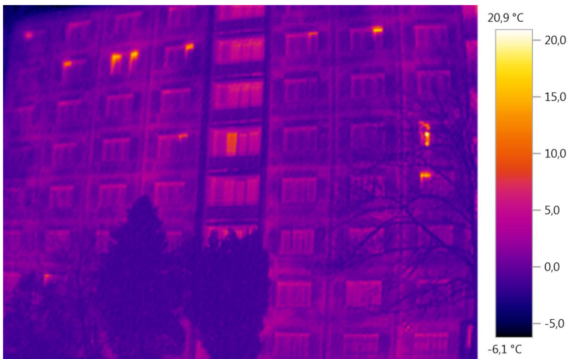
Obr. 4.6 Severozápadní strana ventilační systémy
