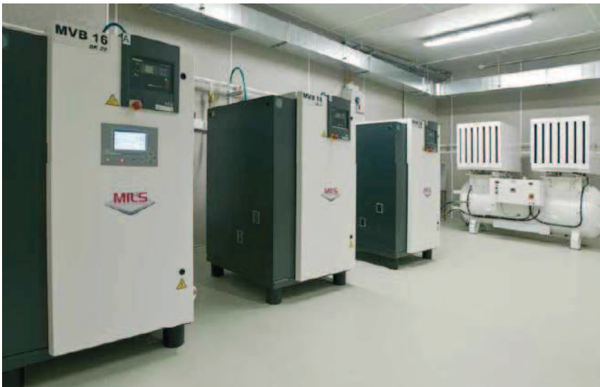
Obrázek 10 Ukázka kompresorové stanice. [74]
