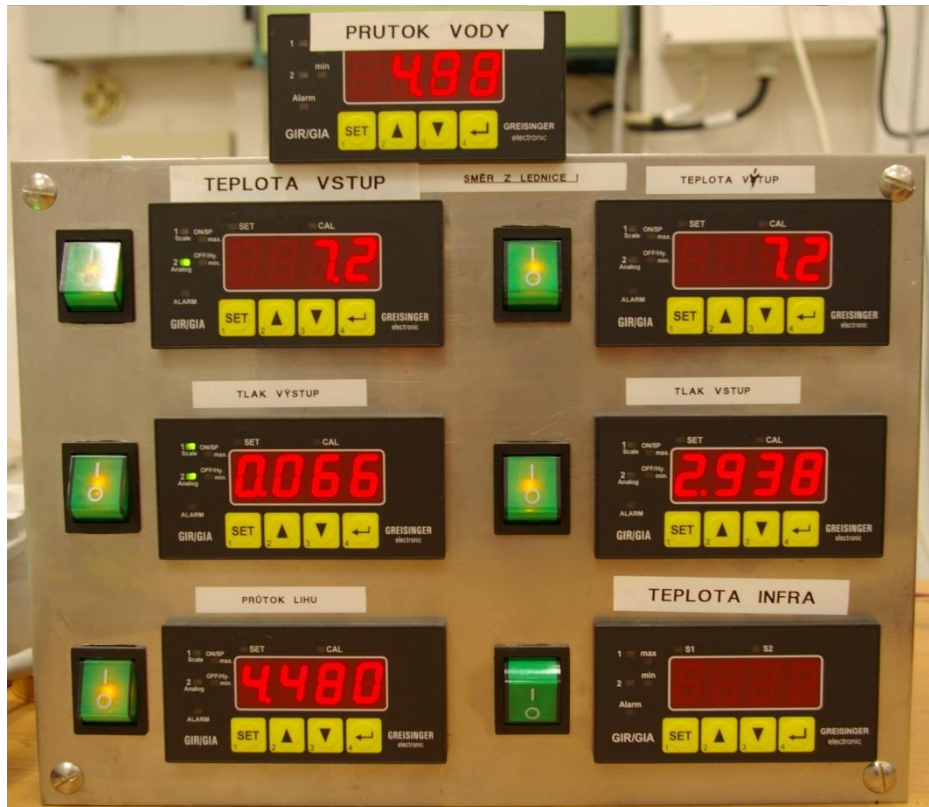
Obr. 11. Měřicí přístroje chladícího zařízení
