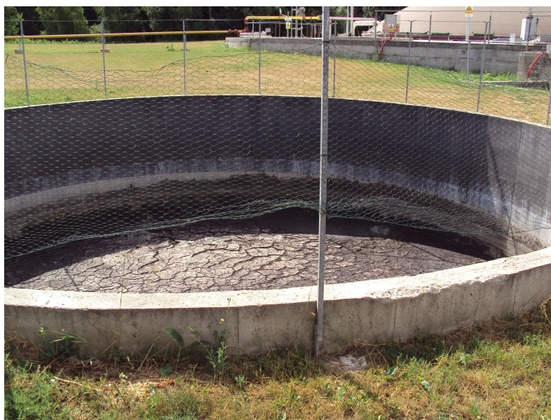
Obrázek 10: Silážní jímka na kontaminované vody
