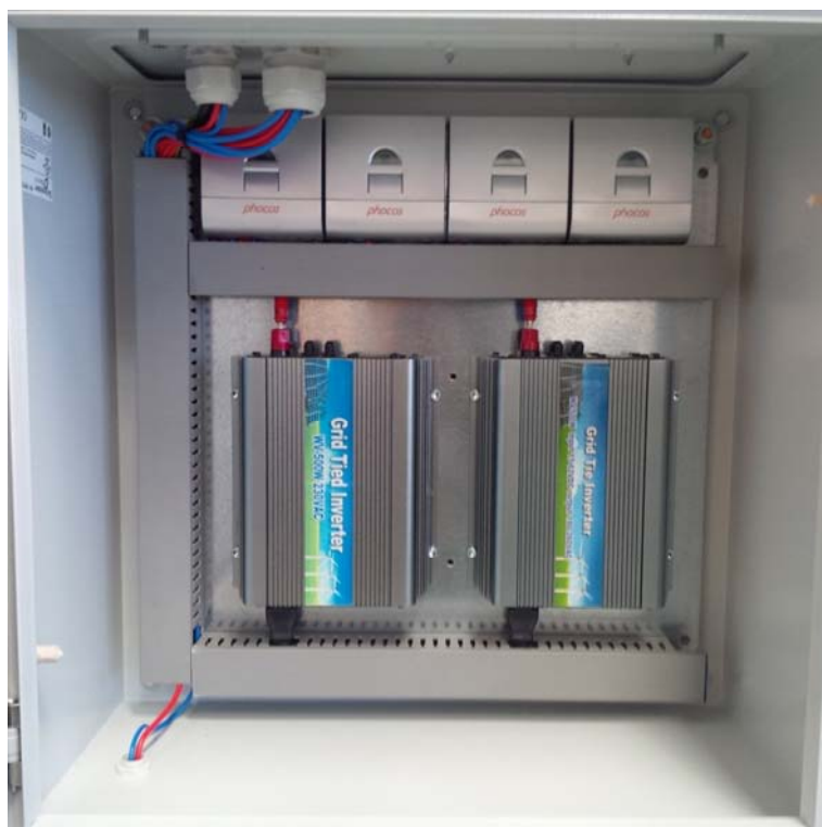
Příloha 2, Obr. 5: Pohled na montážní desku rozváděče R02
