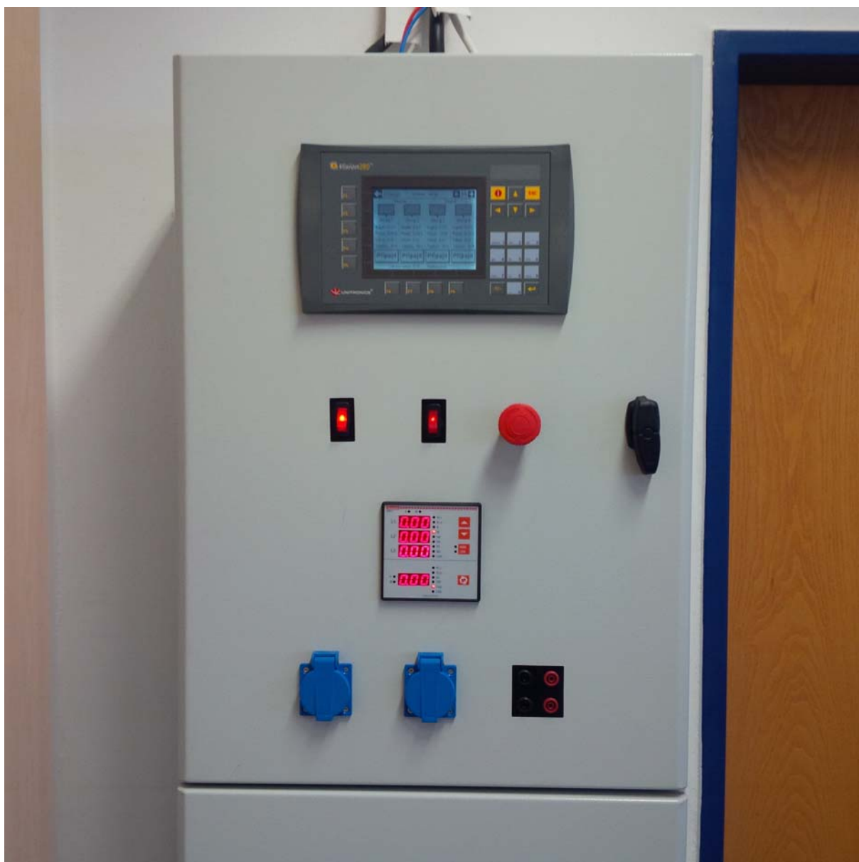
Příloha 2, Obr. 1: Pohled na dveře rozváděče R01
