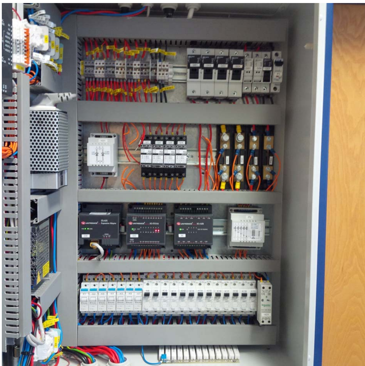
Příloha 2, Obr. 2: Pohled na montážní desku rozváděče R01
