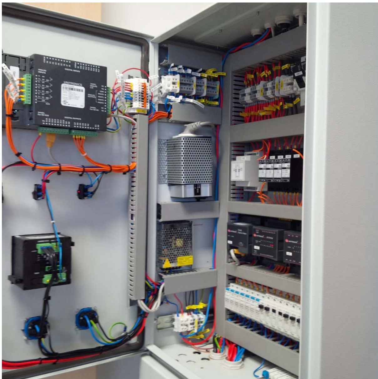
Příloha 2, Obr. 3: Pohled vnitřní levý bok rozváděče R01
