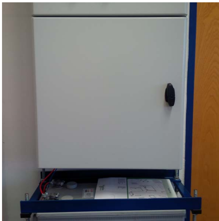
Příloha 2, Obr. 4: Pohled na dveře rozváděče R02
