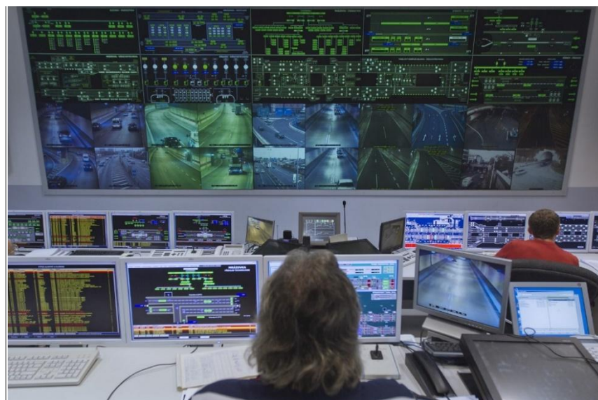
Obr. 1.4 Velín tunelového komplexu Blanka [3]
