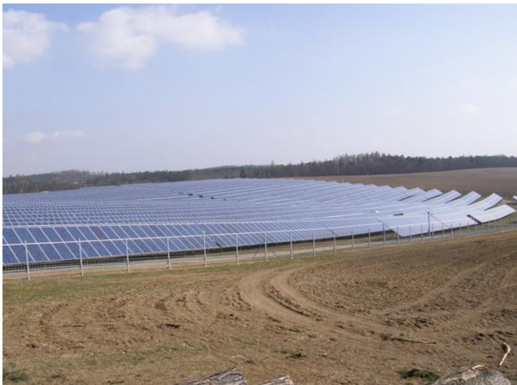
Obr. 29 Fotovoltaická elektrárna Vranovská Ves [7]
