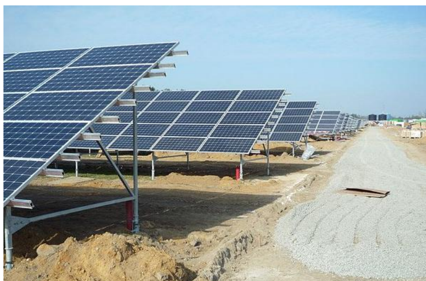
Obr. 28 Fotovoltaická elektrárna Mimoň [7]
