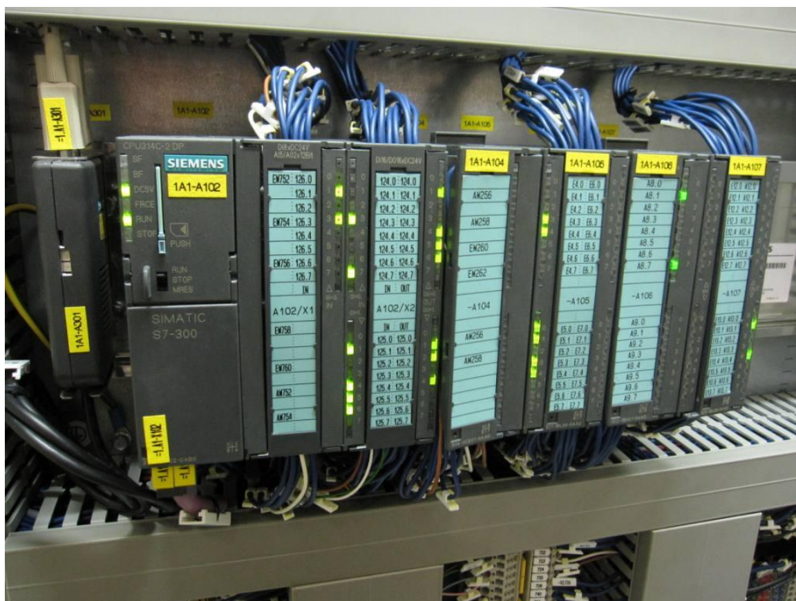
Obr. 6. PLC řízení s moduly
