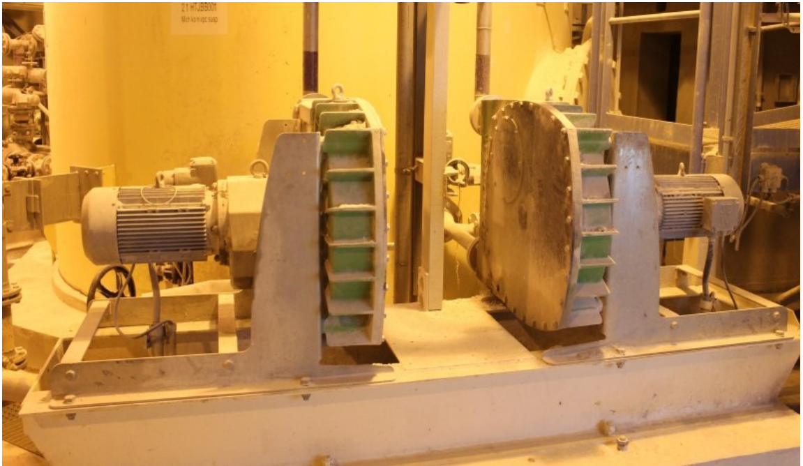
Obr. 2.8 Čerpadla vápencové suspenze
