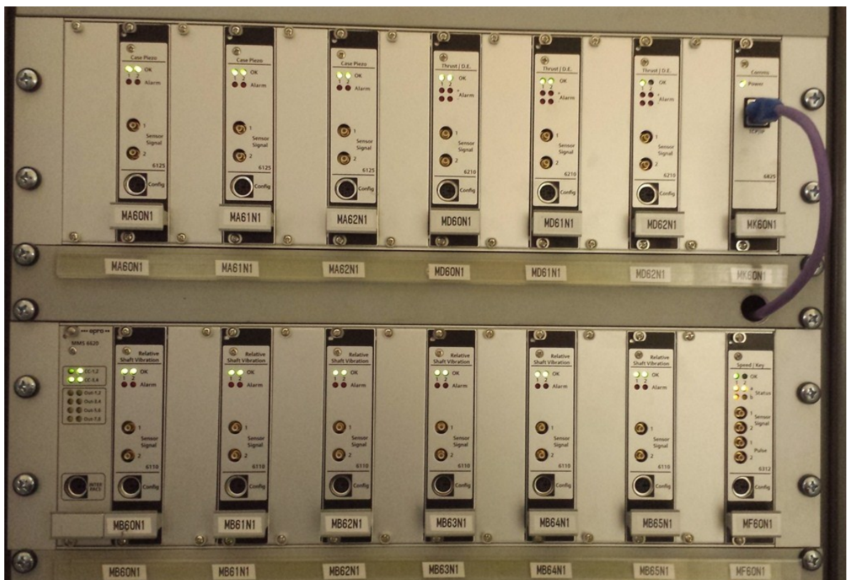
Obr. 2.5 Měřící karty nového diagnostického systému TG3 v rozvaděči posuvů a chvění
