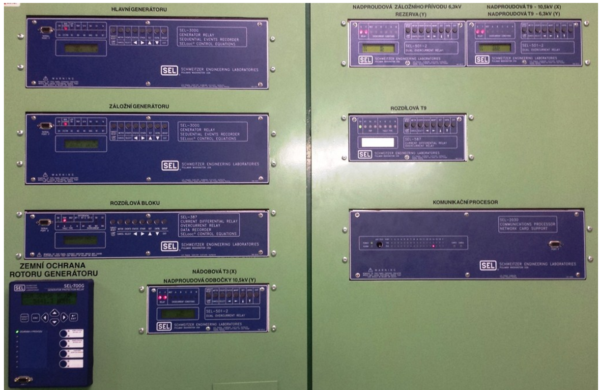
Obr. 3.10 Elektrické ochrany TG3 výrobce SEL v ETI
