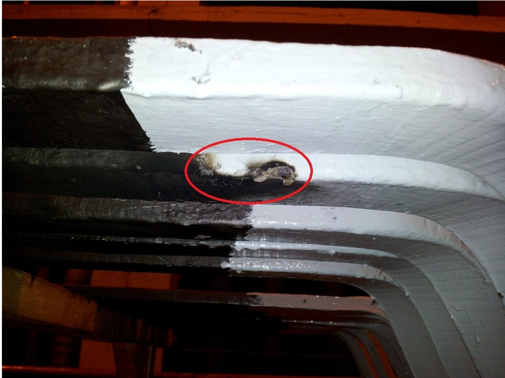
Obr. 1.32 Detail průrazu izolace statorové tyče TG3 - po napěťové zkoušce 26,4 kV/50 Hz/1 min.
