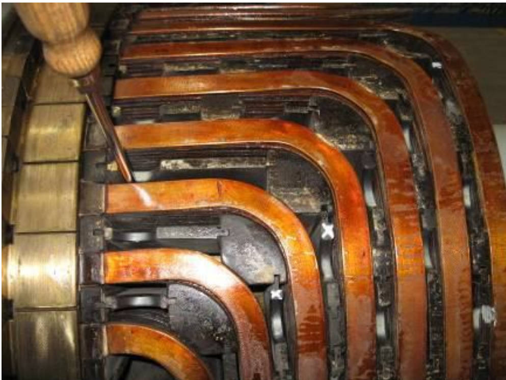
Obr. 1.35 Závada zjištěna při vstupní prohlídce u vinutí rotoru TG3 (převzato z [32])
