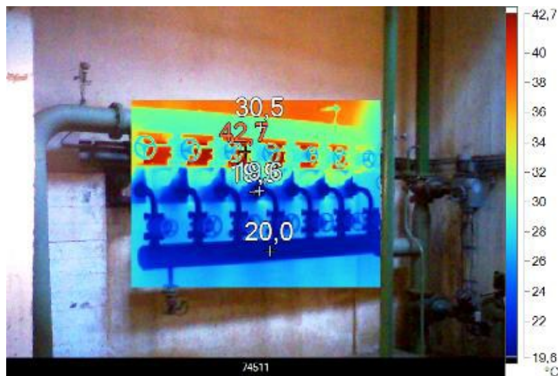
Obr. 1.22 Snímek chladičů z měření před odstavením stroje do opravy (převzato z [24])
