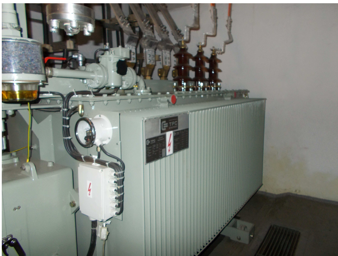
Obr. 3.4 Transformátor vlastní spotřeby EOR
