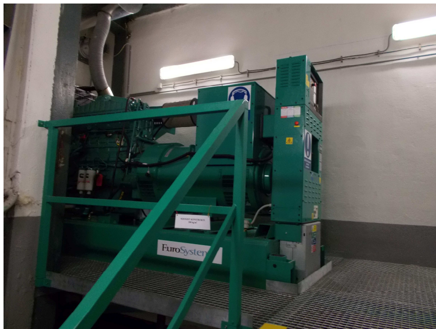
Obr.3.3 Dieselažregát vodní elektrárny Orlík
