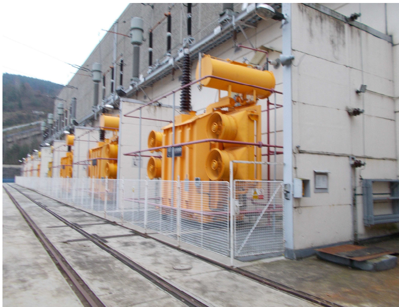
Obr. 3.0. Blokové transformátory elektrárny Orlík
