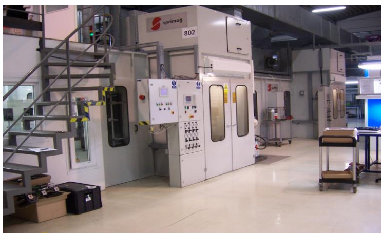
Obr. 27 – Lakovací automat Sprimag
