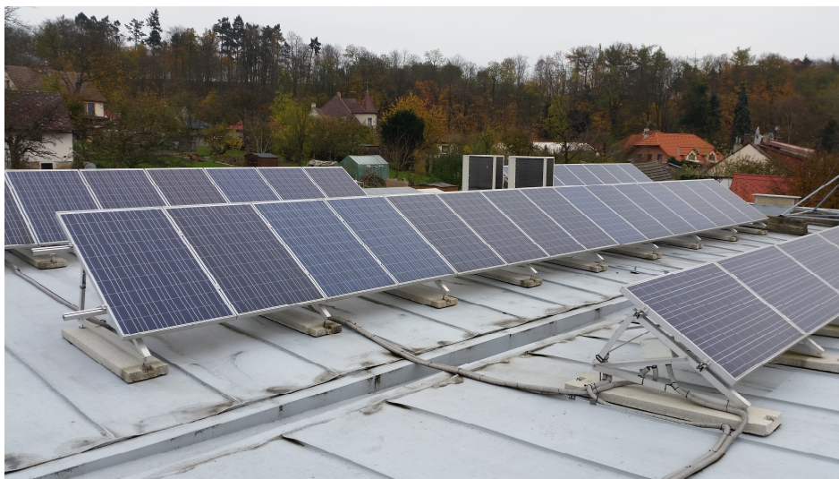
Obr. 1.5 Fotovoltaická elektrárna 9,2 kWp
