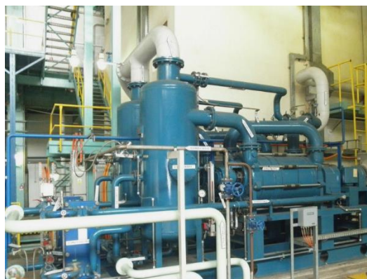
Obr. 8 Systém vodokružných vývěv vsazených v rámu
