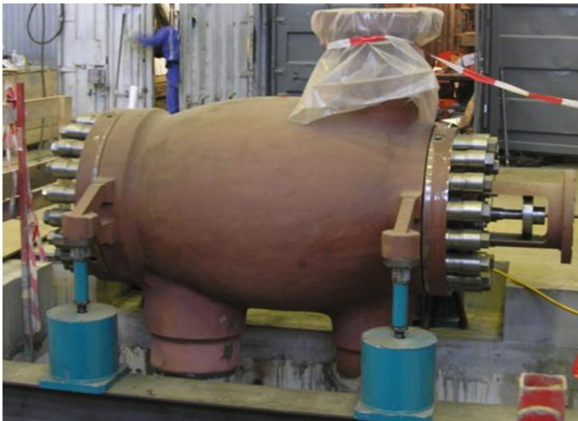
Obrázek 9 – ST RT ventil na pozici na stavbě [10]
