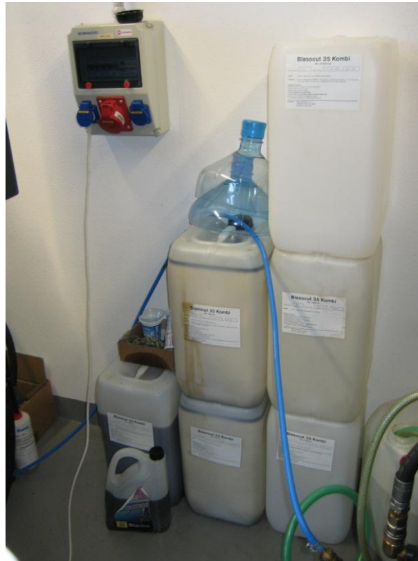
Obr. 2-13 Skladování procesních kapalin
