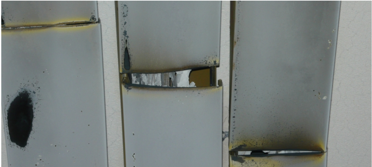
Obr. A-15: Pohled na kabelové kanály po 90 minutové zkoušce v trase WD7 až WD9
