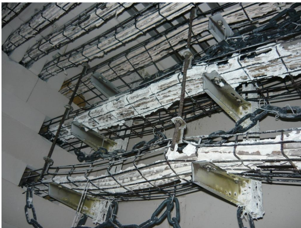
Obr. A-11: Pohled na kabely a kabelové žlaby po 90 minutové zkoušce (trasy M7 až M9, v levé horní části fotografie trasy G2 až G6)
