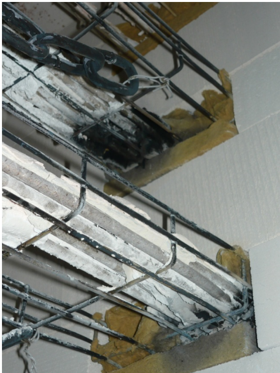
Obr. A-12: Pohled na kabely a kabelové žlaby po 90 minutové zkoušce (trasy M4 až M6)
