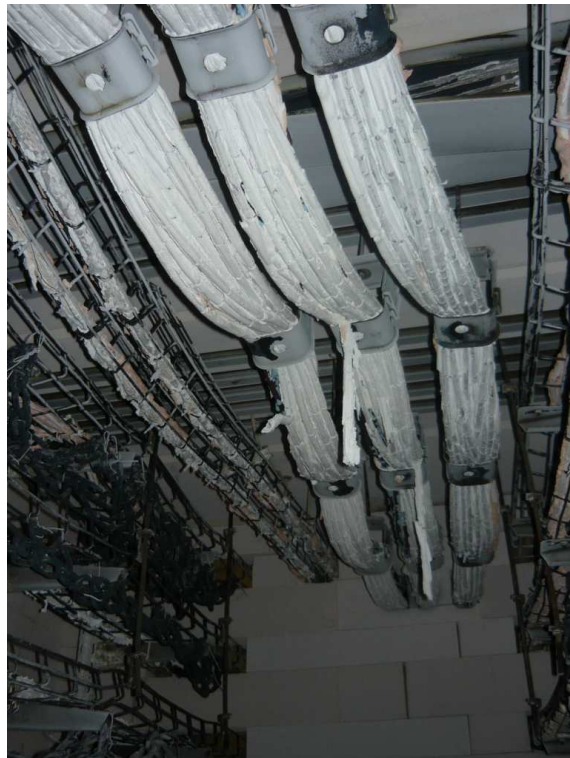
Obr. A-13: Pohled na kabelové trasy po 90 minutové zkoušce (trasy P1 až P3 ve sponách, v levé části trasy G7 a G8 v drátěných žlabech)
