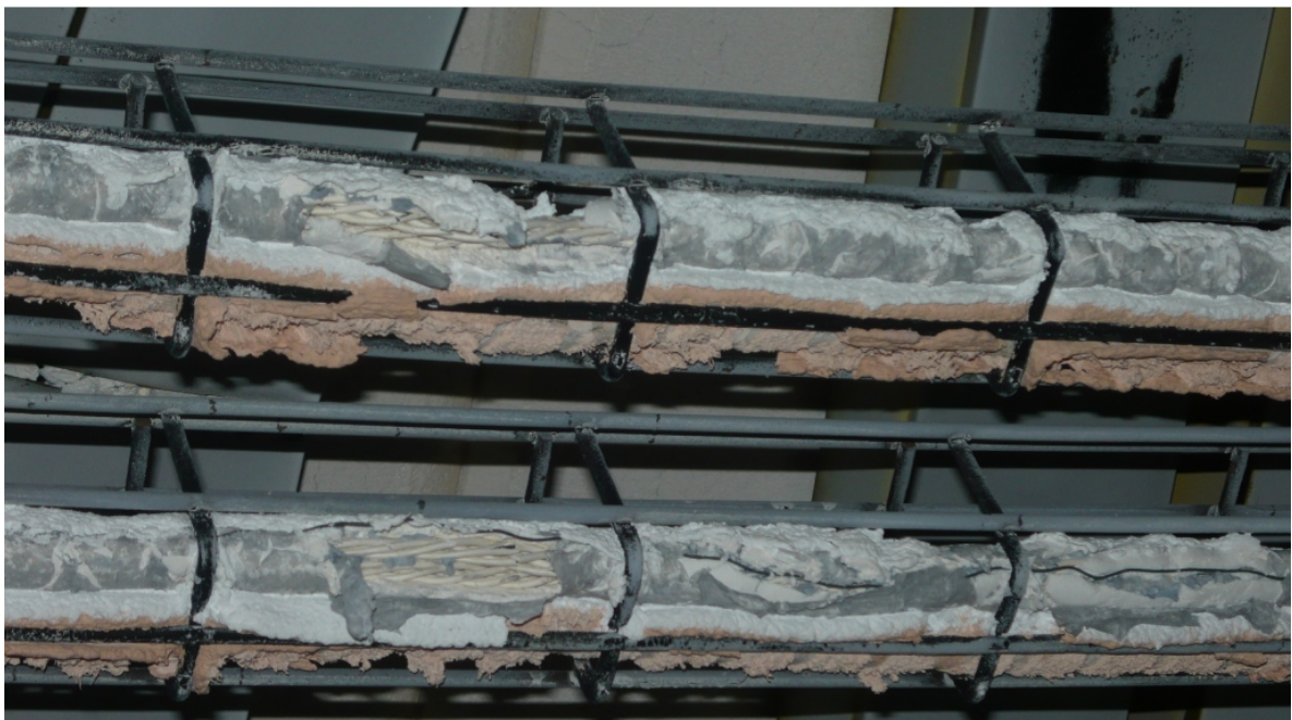
Obr. A-16: Pohled na kabely a kabelové žlaby po 90 minutové zkoušce v trasách G7 a G8
