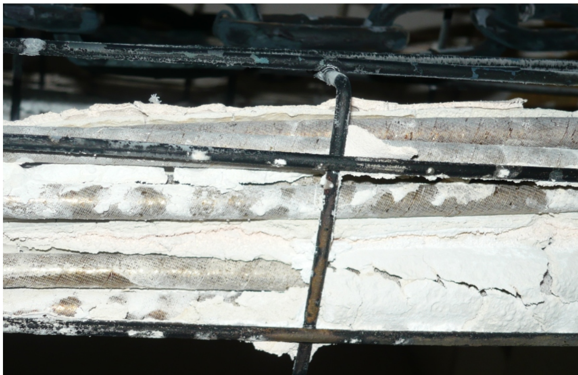
Obr. A-14: Pohled na kabely a kabelové žlaby po 90 minutové zkoušce v trase M6
