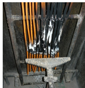
Obr. 8: Měřený svazek kabelů po zkoušce
