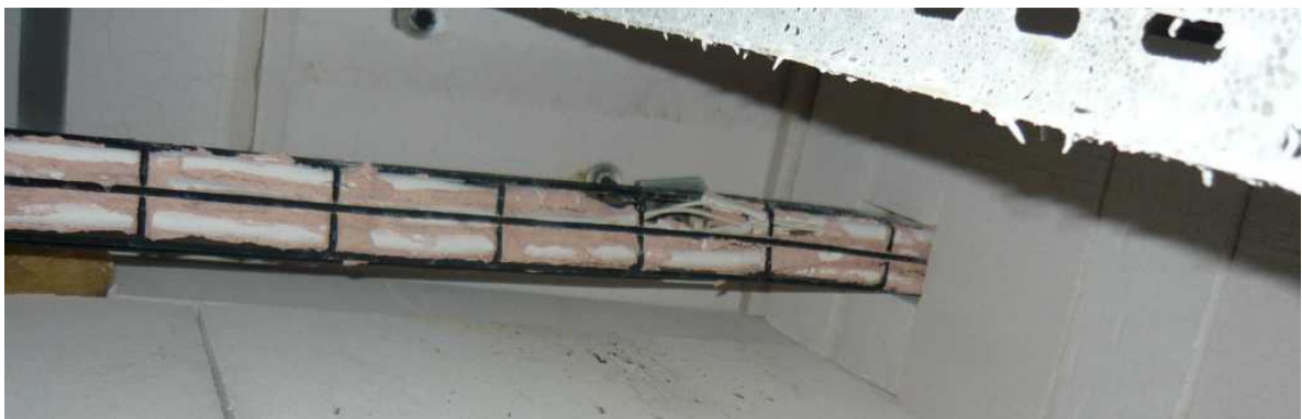
Obr. A-17: Pohled na kabely a kabelový žlab po 90 minutové zkoušce v trase G9
