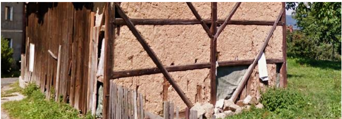
Obr. 47. Chybějící výplň hrázděné stěny u přízemní stodoly ve Starém Týnu (snímek z roku 2011, v době před zánikem objektu)
