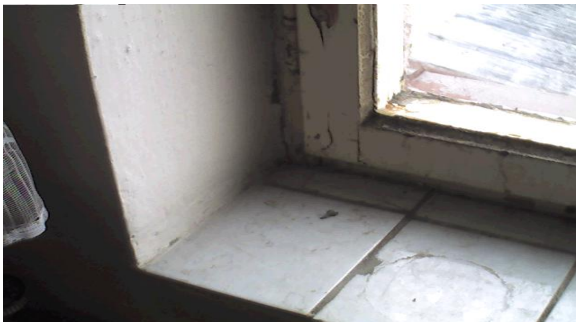
Obr. 14 - promrzající okenní rám nezatepleného bytu
