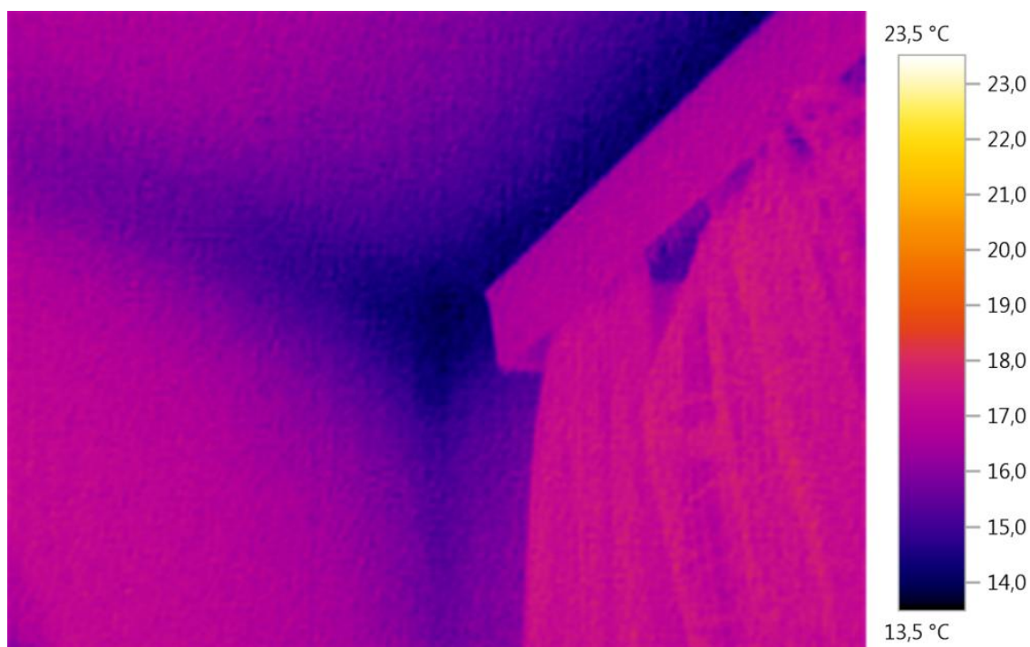
Obr. 15 - Roh místnosti nezatepleného bytu
