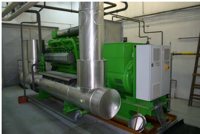
Obr. č. 14: Kogenerační jednotka
