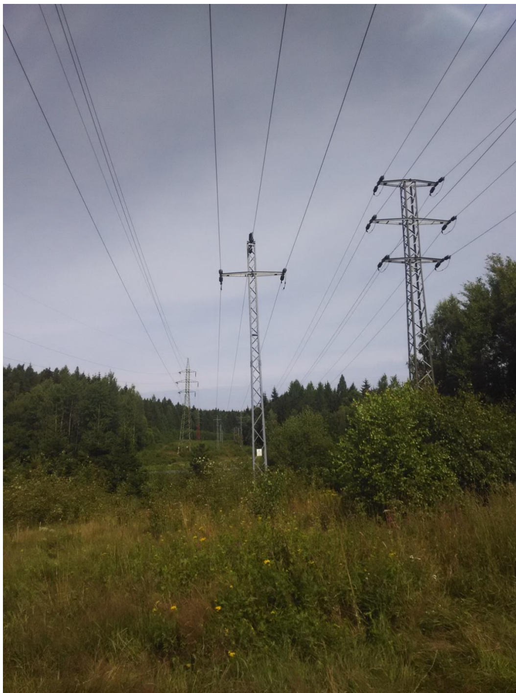
Souběh vedení 35 kV a 110 kV u rozvodny Podhájí [autor]
