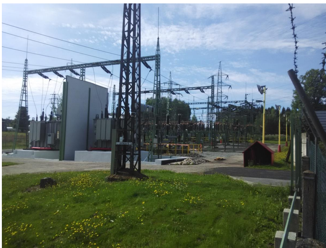
Rozvodna Podhájí [autor]
