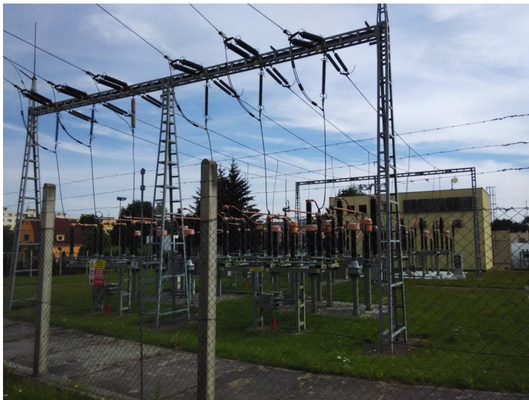
Rozvodna Varnsdorf [autor]
