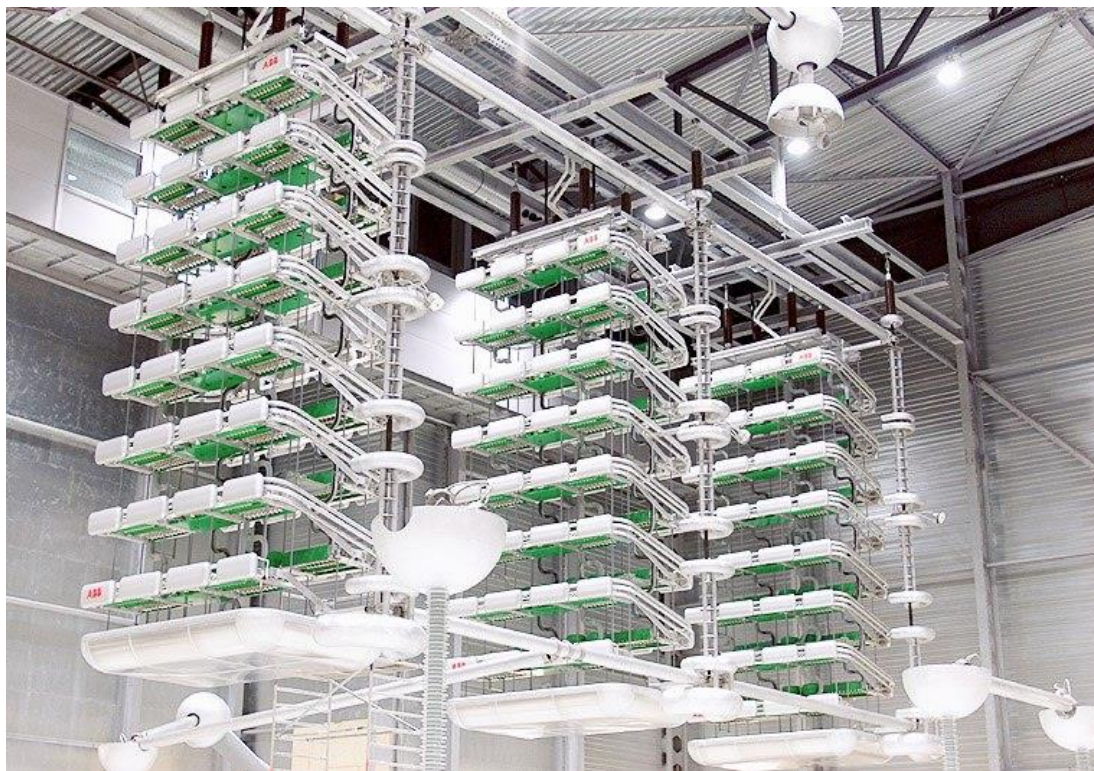
Obr. 2-1: Hala s měničovými prvky, NorNed Eemshaven [19]
