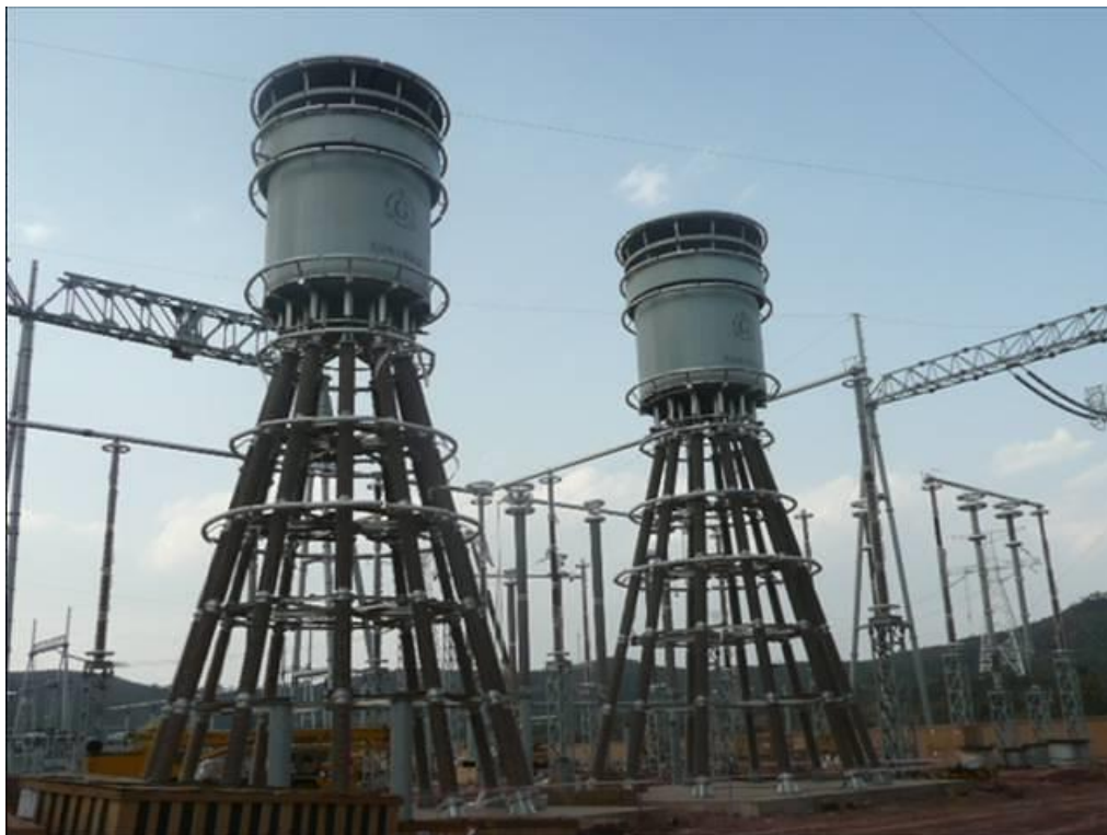
Obr. 2-2: Tlumivky v HVDC rozvodně 800 kV v západní Číně [18]
