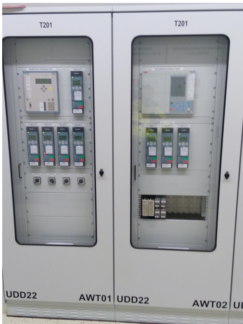
Obrázek A.5 Sestava rozváděčů ochran transformátoru T201 TR Milín
