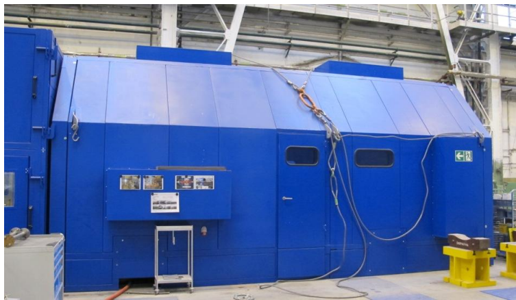
Obr. č. 14: Snížení hluku pozadí protihlukovým krytem
