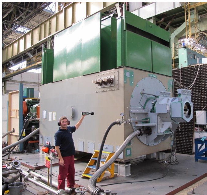
Obr. č. 2: Měření hluku turbogenerátoru
