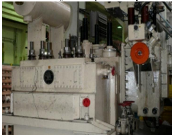
4. Trakční transformátory a tlumivky
