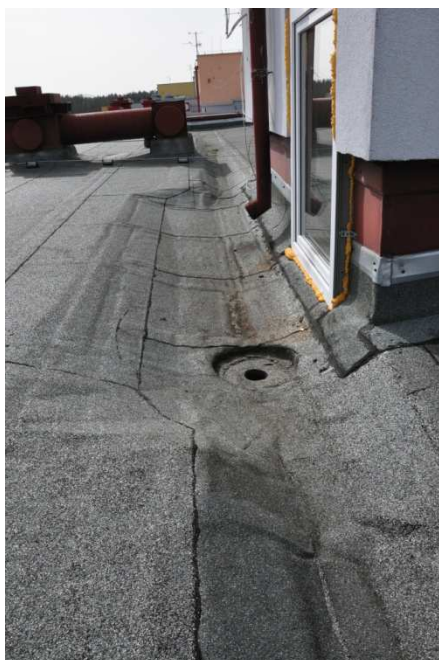
Obrázek 48: Termogram ploché střechy na panelovém domě v Českých Budějovicích. Vpust'
