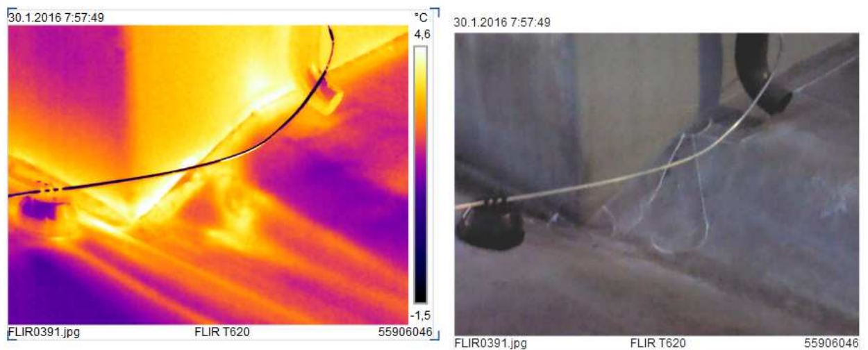
Obrázek 41: Termogram ploché střechy na panelovém domě ve Strakonících. Roh strojovny.
