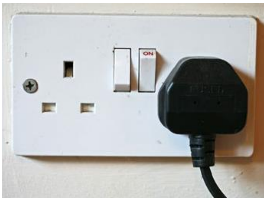
Obrázek 61: Typické provedení zásuvky v UK s vypínači.
